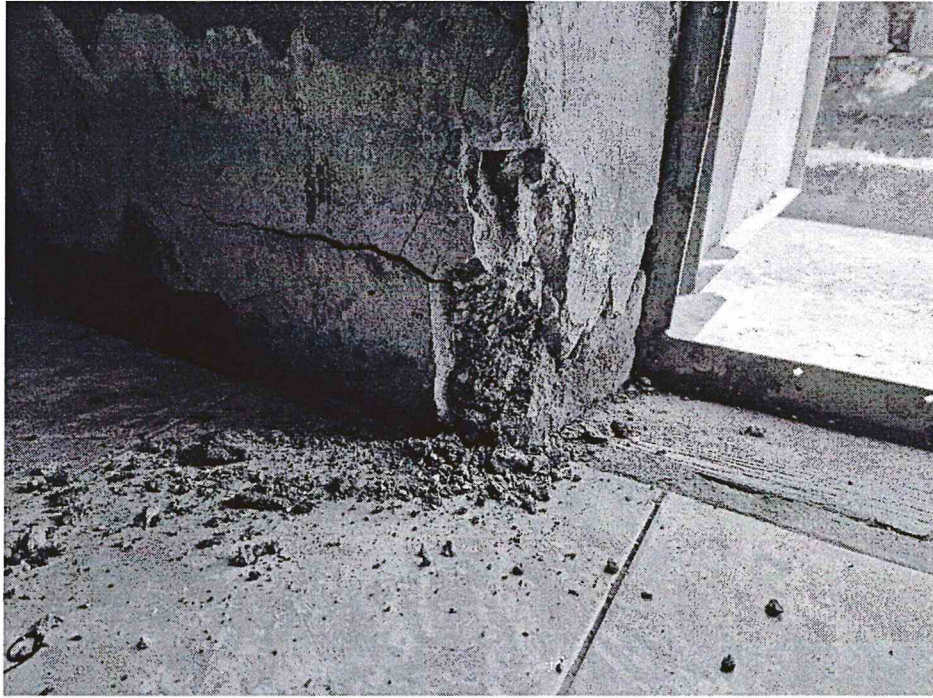
Fig. 9.7. Infiltratii si degradare pereti
