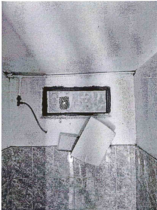
Fig. 9.4. Vedere interioara-degradari instalatii
