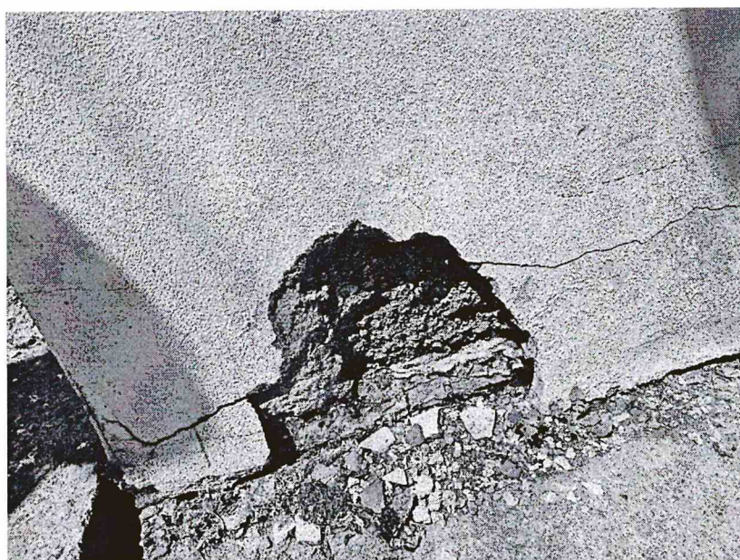
Fig. 9.6. Infiltratii si degradare pereti
