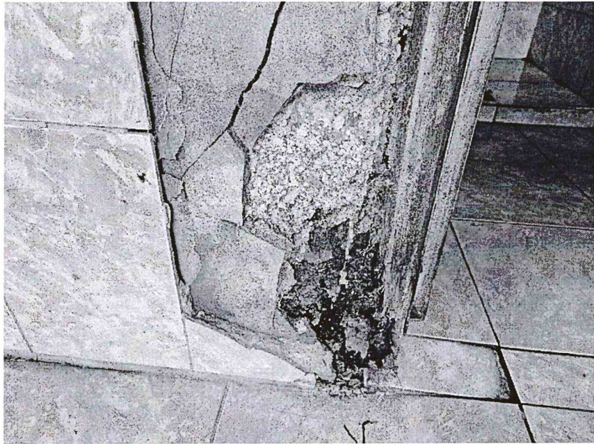
Fig. 9.9. Infiltratii si degradare pereti
